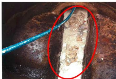
下水道の詰まりの原因!!!
