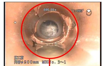
下水道が破損した状況をカメラ搭載車で撮影した様子
